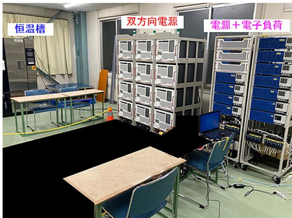
ポニー電機に設置した遠隔実験室（提供：ポニー電機）
